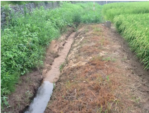
写真-4 右岸8.6k付近の噴砂状況 9)
