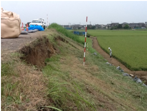
写真-3 右岸8.4k付近のすべり破壊発生箇所 9)
