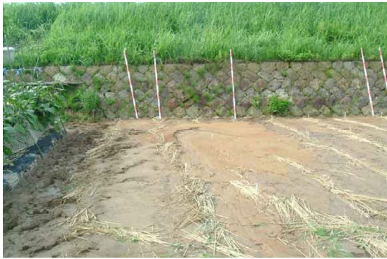
写真-1 白江地区(左岸6.6k付近)の漏水状況(噴砂) 7)
