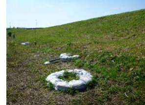
写真-1 鬼怒川平成27年9月洪水時の堤防被災箇所の例(左岸20.5k付近、堤体浸透破壊の危険性が大きかった箇所)
