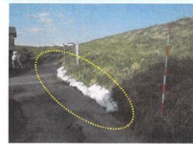
(a) 堤防漏水
