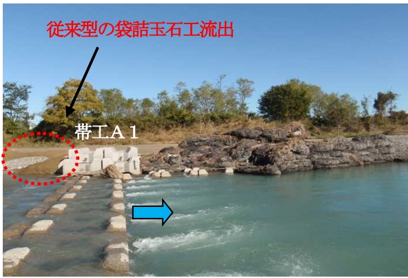
図-7 帯工A1上流の従来の袋詰玉石工流出状況（洪水後）
