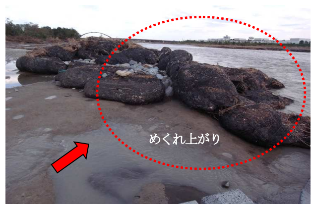
図-9 改良型袋詰玉石工のめくれ状況（洪水後）
