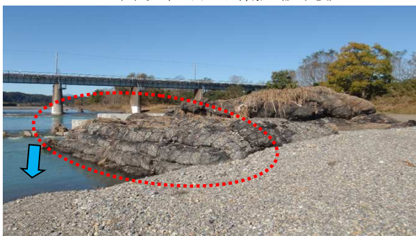
図-8 改良型袋詰玉石工による法面洗掘対策の効果(洪水後)
