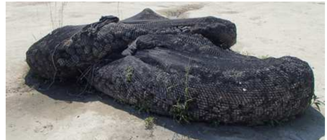
図-3 流出した袋詰玉石工の状況
