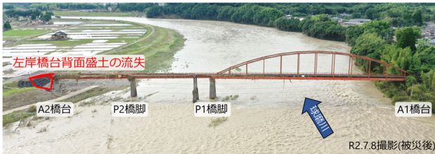
(a)天狗橋(56km)の被災状況
