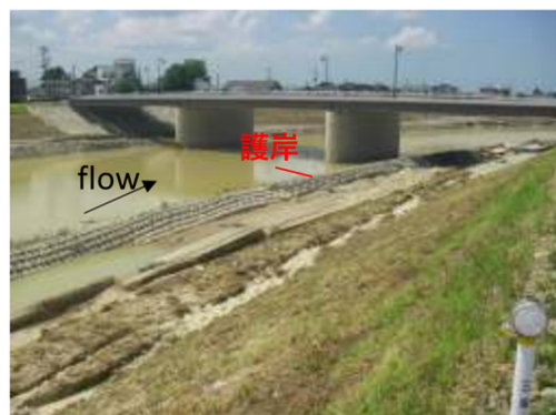
図-2 H23 年洪水時 内岸側高水敷・低水護岸被災状況(1.1km) 5)
