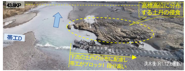
写真-6 帯工D右岸側直下流の土丹侵食
