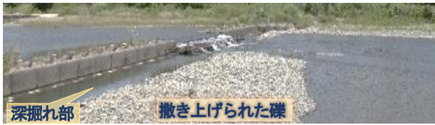
写真-2 連続壁型帯工:深掘れ部とその下流の礫の撒き上げ
