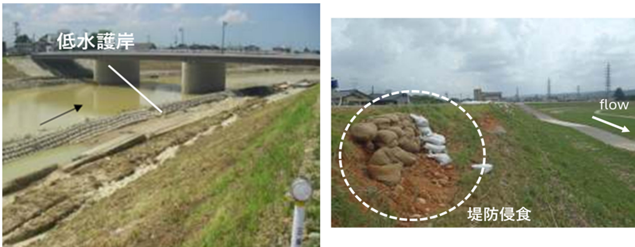
(a) 内岸高水敷・低水護岸洗掘(1.1km内岸)
