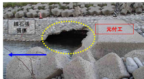
図-4 元付工下流の練石張護岸の損傷状況 (右岸11.9k)
