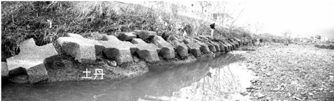
写真-2 9.2km付近の根固め工崩落状況(右岸側)
