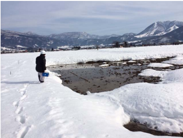
写真-1 2013年9月右岸31.5k付近の漏水発生箇所の融雪期の湧水状況(2014年3月調査時)
