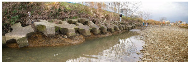
写真-5 浅川9.2km右岸水衝部の根固め工崩落状況 13)
