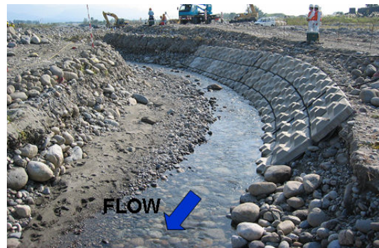
(b) 護岸付近の深掘れ
