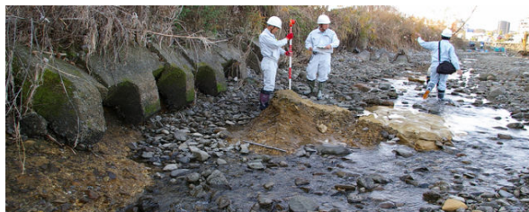
写真-6 浅川9.2km右岸の河岸際河床に露出した土丹 13)
