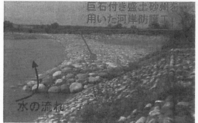
〈写真一2〉 安倍川右岸8.5kmの巨石付き盛土砂州
