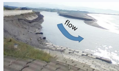
図-2 物部川の河岸護岸侵食
