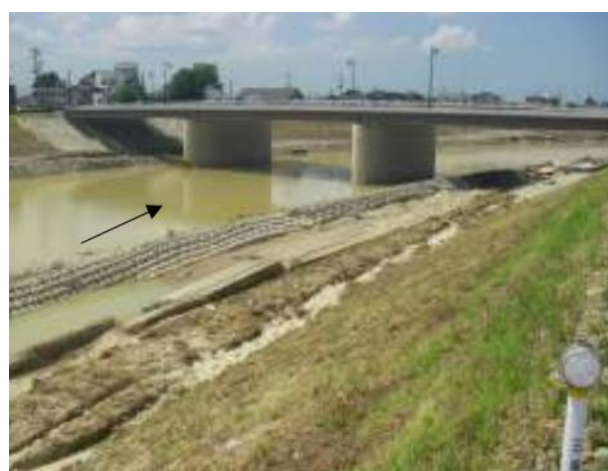
図-11 平成23年7月新潟・福島豪雨時における内岸高水敷・低水護岸の被害状況(1.1km) 5)
