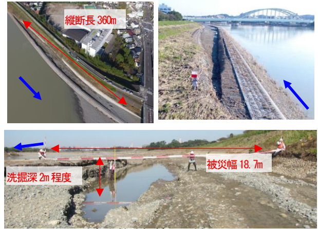
(a)高水敷洗掘被災の様子
