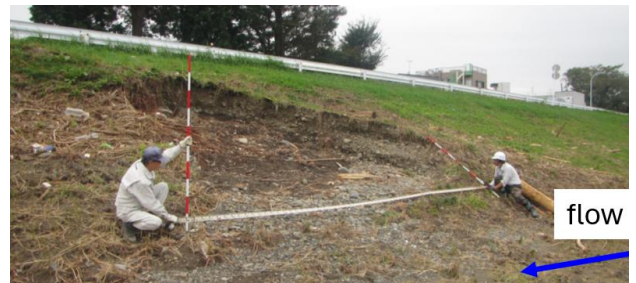
(a)堤防表法面侵食被災の様子
